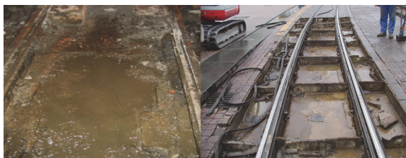
Slika 2. Stanje unutar tramvajskog kolosijeka s lošom odvodnjom
